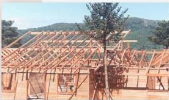
Réception du conteneur, droits de douane, livraison jusqu'au lieu de construction, et montage du kit
